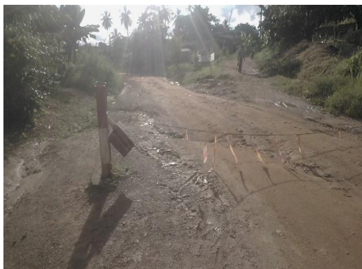
Voiries complètement ravinée
